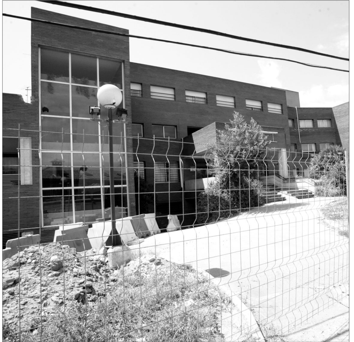
El Ayuntamiento ya ha autorizado a FCC la demolición parcial de la antigua Clínica del Rosario. /D. PÉREZ
